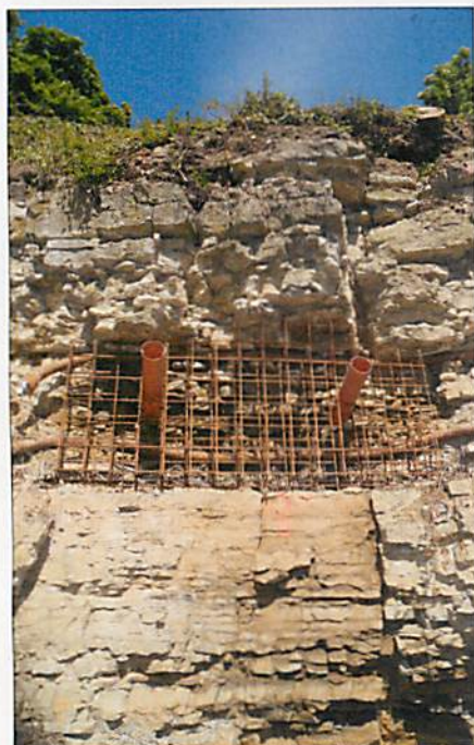
Bedrohlich, gefährlich und furchterregend: Der Zustand vor und während der Sanierung.
