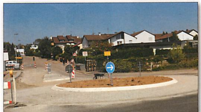
Der neue Kreisverkehr am Ortseingang aus Richtung Unterriexingen kommend, ist so gut wie fertig. Die offizielle Übergabe des Abschnittes zwischen dem „kleinen Kreisverkehr“ und dem „großen Kreisverkehr“ beim Kinderspielplatz steht vor der Übergabe.
