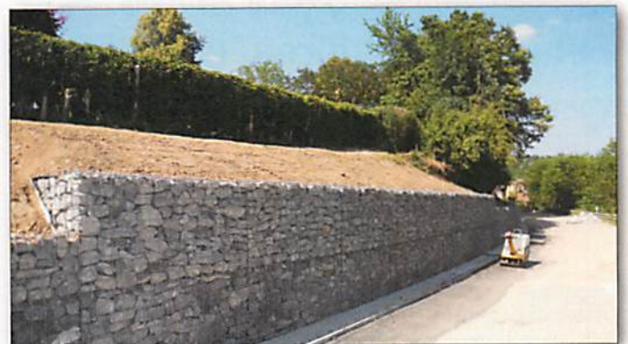
Das gefährliche Stück Unterriexinger Straße oberhalb der einsturzgefährdeten Felswand ist saniert. Eine Gabionenwand wertet diesen Teil der Straße auch optisch auf.
