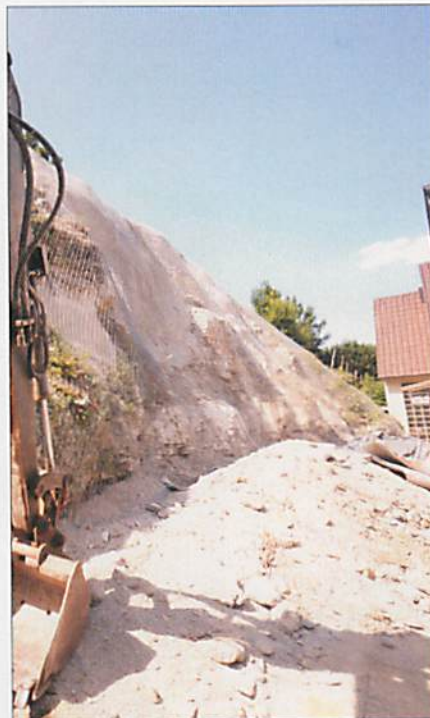
Aufwendig saniert und gesichert. Die Felswand direkt im Anschluss an die Häuser.
