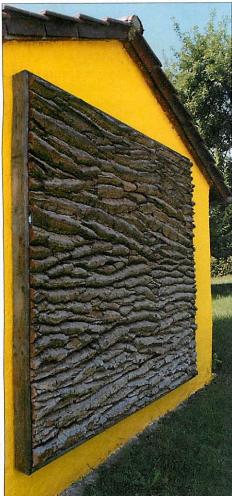
Wengerthäusle im „Förstle“ am Steinbruchweg. Alternative Fassadengestaltung durch Hobbykünstler Werner Wahler
